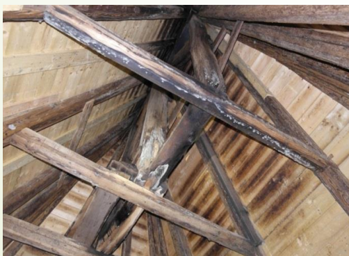
Hölzerne Strukturen in der Kirche in Günserode (Thüringen). Man erkennt Verfärbungen und auskristallisierte Salze.
